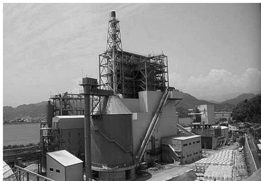
写真 1 紀州製紙株式会社 CFBボイラ Photo 1 KISHU PAPER Co., Ltd. CFB Boiler
